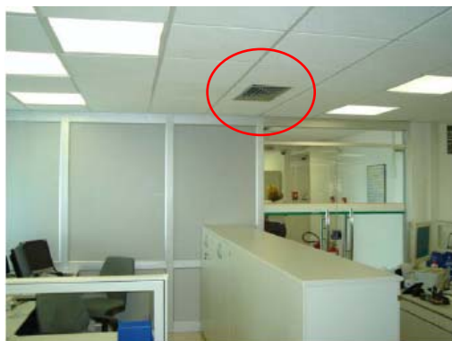
Figura 3.10 – Difusor próximo ao posto de trabalho
