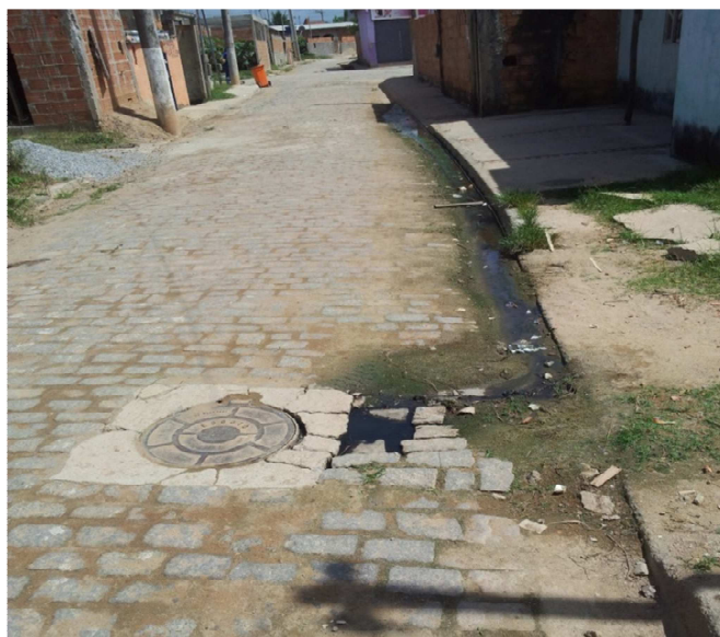
Figura 60 – Fotografia de vazamento na Rua Bahia, em 15/03/2013. Fonte: o autor.
