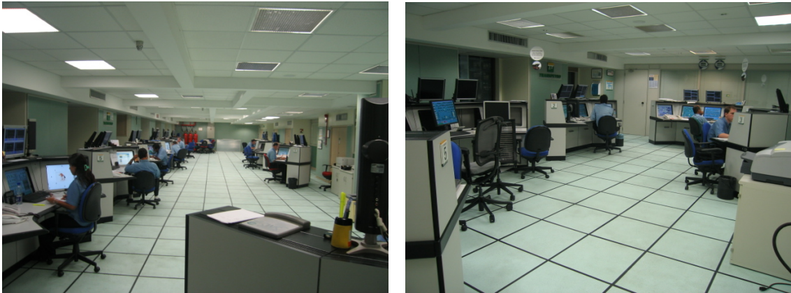
Figura 35 – Salas de controle existentes: à esquerda a sala de controle de óleo e a direita a sala de controle de gás.
