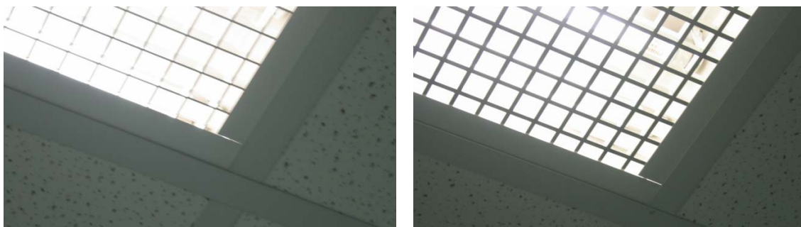
Figura 38 – A esquerda detalhe da grelha plástica duplo parabólica das luminárias. A direita detalhe da grelha plástica invertida.
