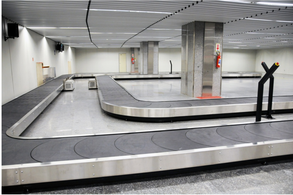
Figura 30. Esteira de bagagens com o destaque para o botão de parada de emergência.
