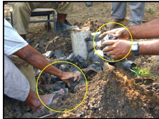
Foto 38 - Falta de uso de equipamento individual
