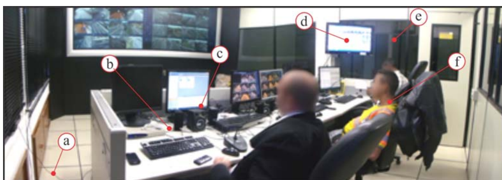
Foto 24 – Sala de monitoramento
