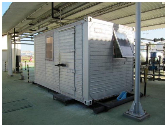
Figura 41: Sala de controle da UTVGL
